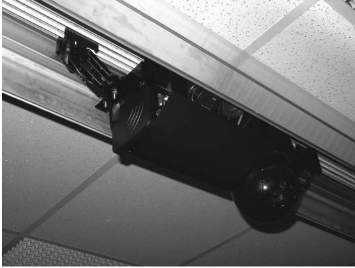
Figure 5.10 – Caméra motorisée sur rail.
